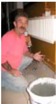
Ułożenie terakoty oraz cokołów przy podłodze ułatwia utrzymanie czystości przy dużym ruchu
